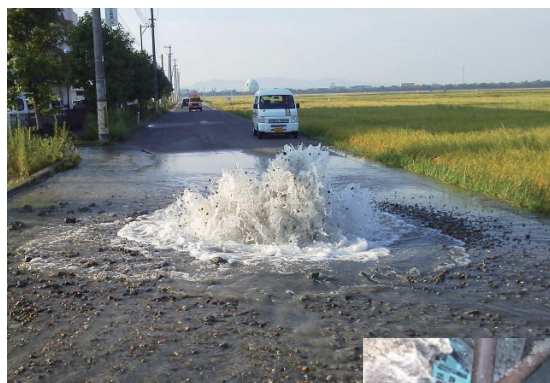
◀水道管の漏水状況
